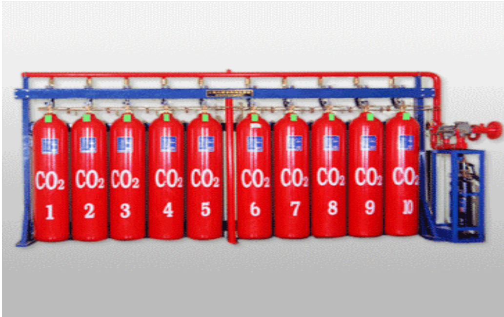
Εικόνα 3.11: Αυτόματο σύστημα κατάσβεσης με διοξείδιο του άνθρακα.
