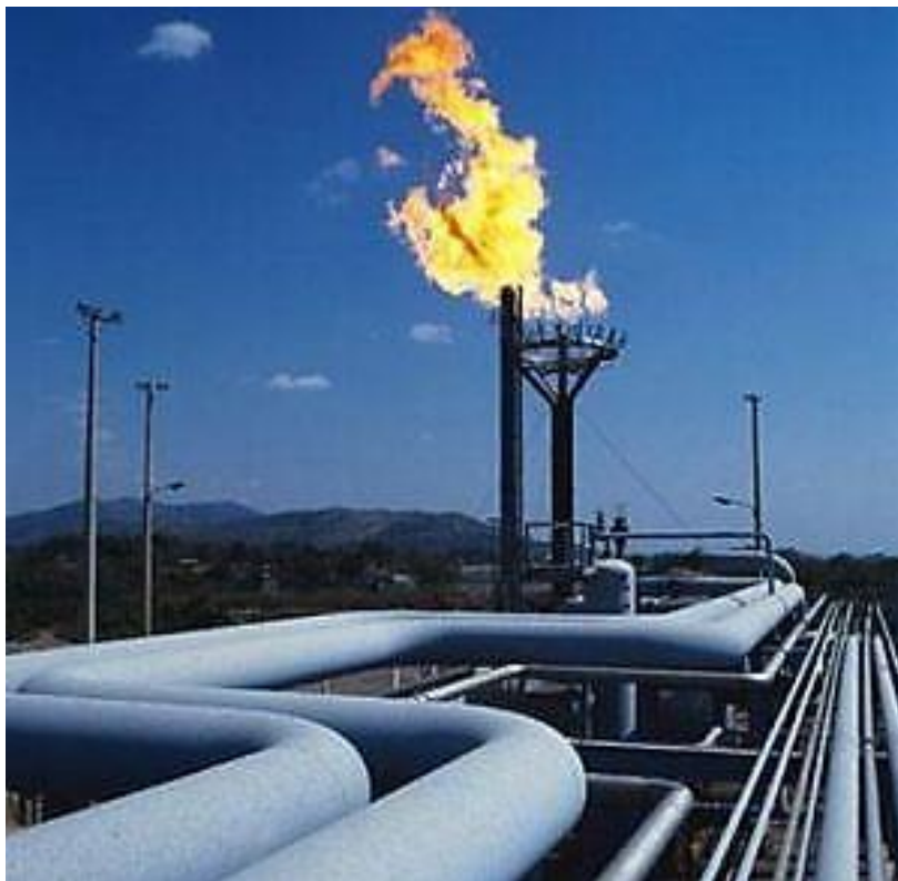
Εικόνα 1.5: Εγκαταστάσεις φυσικού αερίου.
