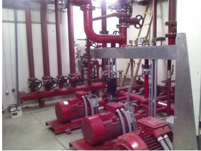
Εικόνα 3.8: Μόνιμο υδροδοτικό σύστημα πυρόσβεσης.
