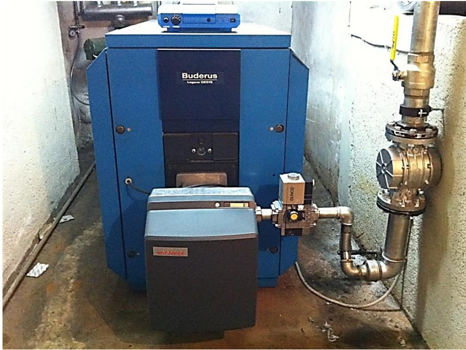
Εικόνα 2.7: Σύνδεση καυστήρα με λέβητα.
