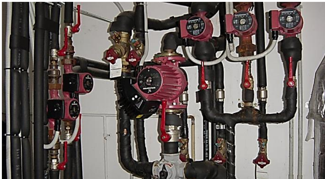
Εικόνα 2.5: Σωληνώσεις κεντρικής θέρμανσης οικιακού λεβητοστασίου.
