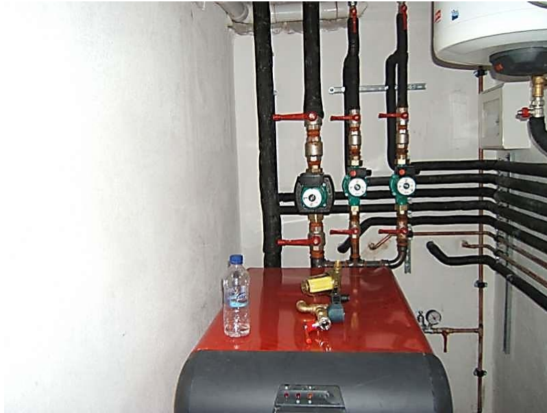
Εικόνα 1.7: Λεβητοστάσιο οικίας στην Αθήνα.
