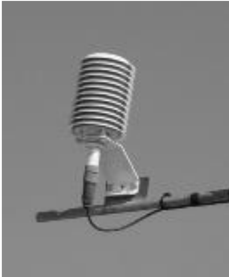
Εικόνα 5.12: Αισθητήριο θερμοκρασίας, εγκατεστημένο στο εργαστήριο ΑΠΕ.
