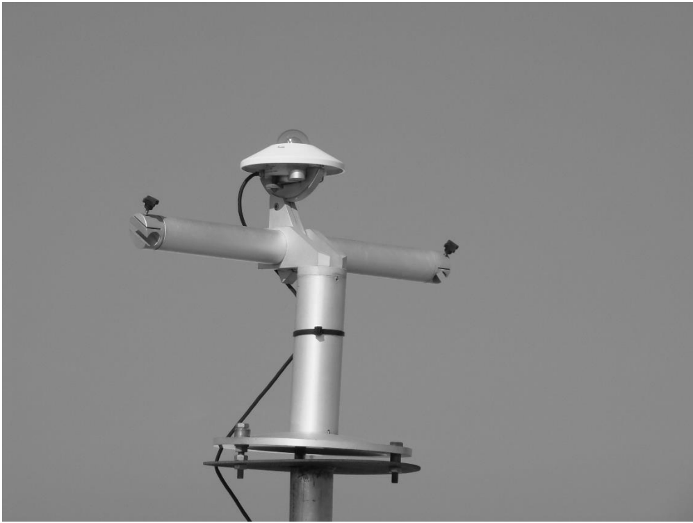
Εικόνα 5.10: Πυρανόμετρο μέτρησης της ολικής ηλιακής ακτινοβολίας στο οριζόντιο επίπεδο, εγκατεστημένο στο εργαστήριο ΑΠΕ.
