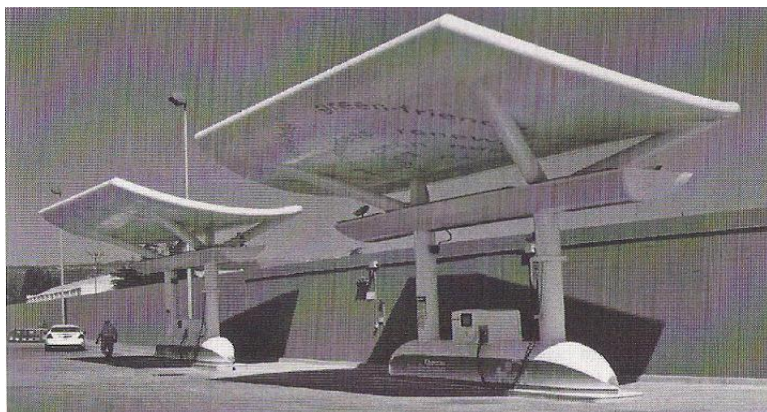
Εικόνα 4.6: Σταθμός τροφοδοσίας συμπιεσμένου υδρογόνου.
