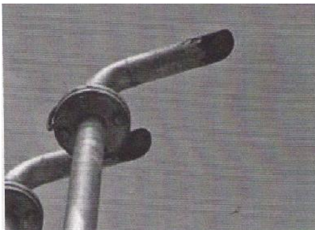
Εικόνα 4.10: Έξοδος Αγωγού εξαερισμού σε σταθμό τροφοδοσίας υδρογόνου.
