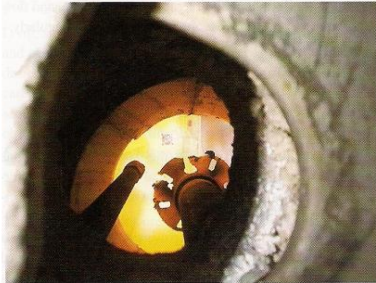
Εικόνα 3.3: Κατεστραμμένος κώνος διαχύτη
