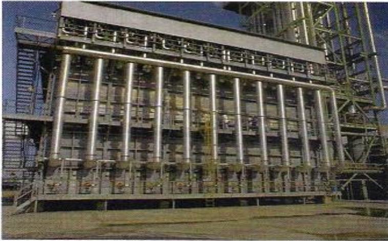
Εικόνα 2.7: Καυστήρες τοποθετημένοι στη πλευρά ενός θερμαντήρα.
