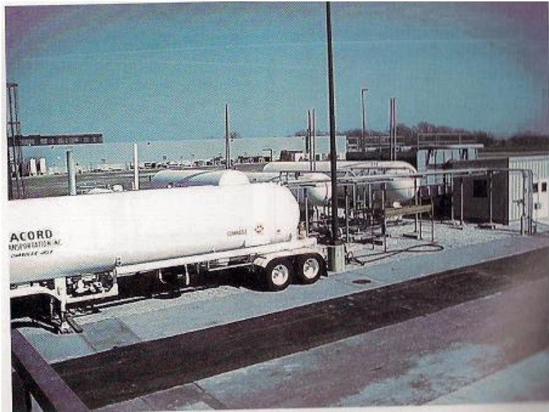
Εικόνα 1.6: Δεξαμενές αποθήκευσης καυσίμων
