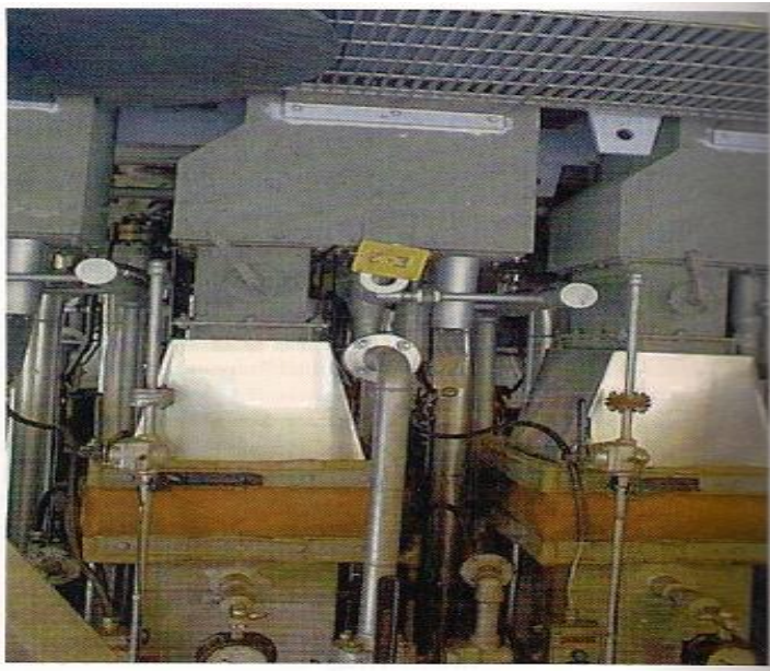
Εικόνα 2.8: Καυστήρας τοποθετημένος στο πάνω μέρος ενός θερμαντήρα.
