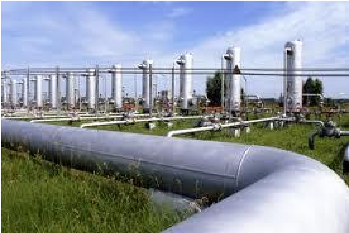
Εικόνα 1.4 :Αγωγός Μεταφοράς Φυσικού Αερίου
