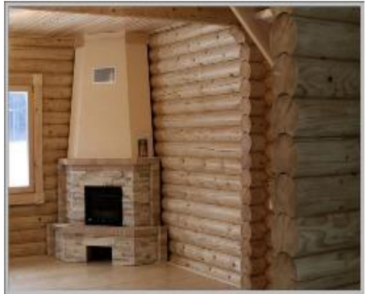
Εικ.1.12: Διακόσμηση τζακιού με μάρμαρο στο χρώμα του χώρου.
