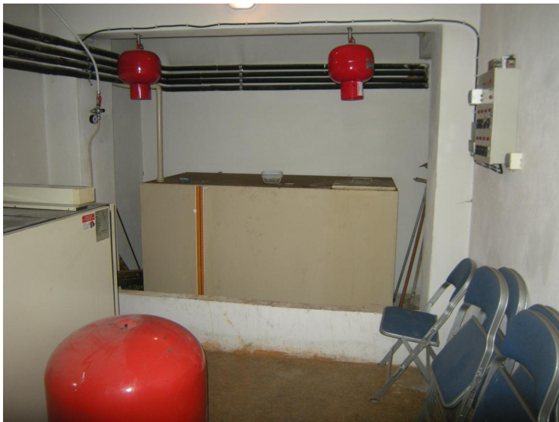
Εικόνα 1 Υπάρχων λέβητας σε εγκατάσταση(πηγή: www.koubarakis.gr )
