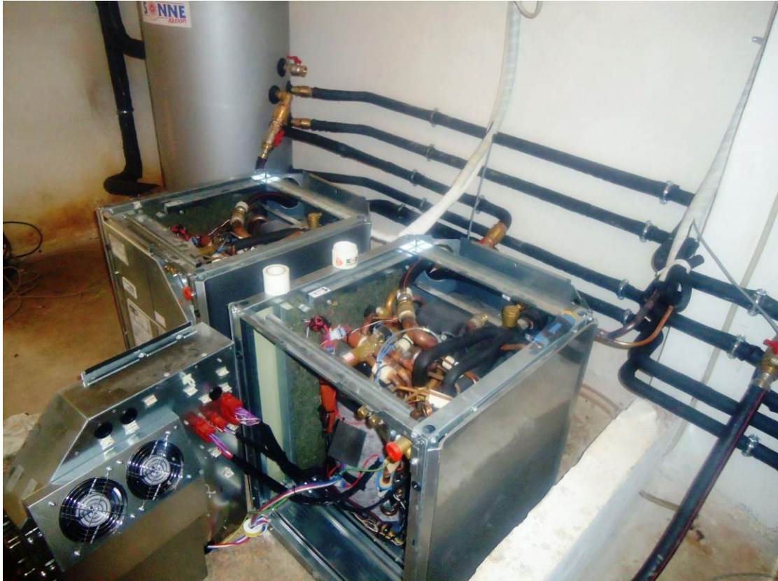
Εικόνα 2 Εικόνα εσωτερικών μηχανημάτων αντλίας θερμότητας σε εγκατάσταση(πηγή: www.koubarakis.gr )
