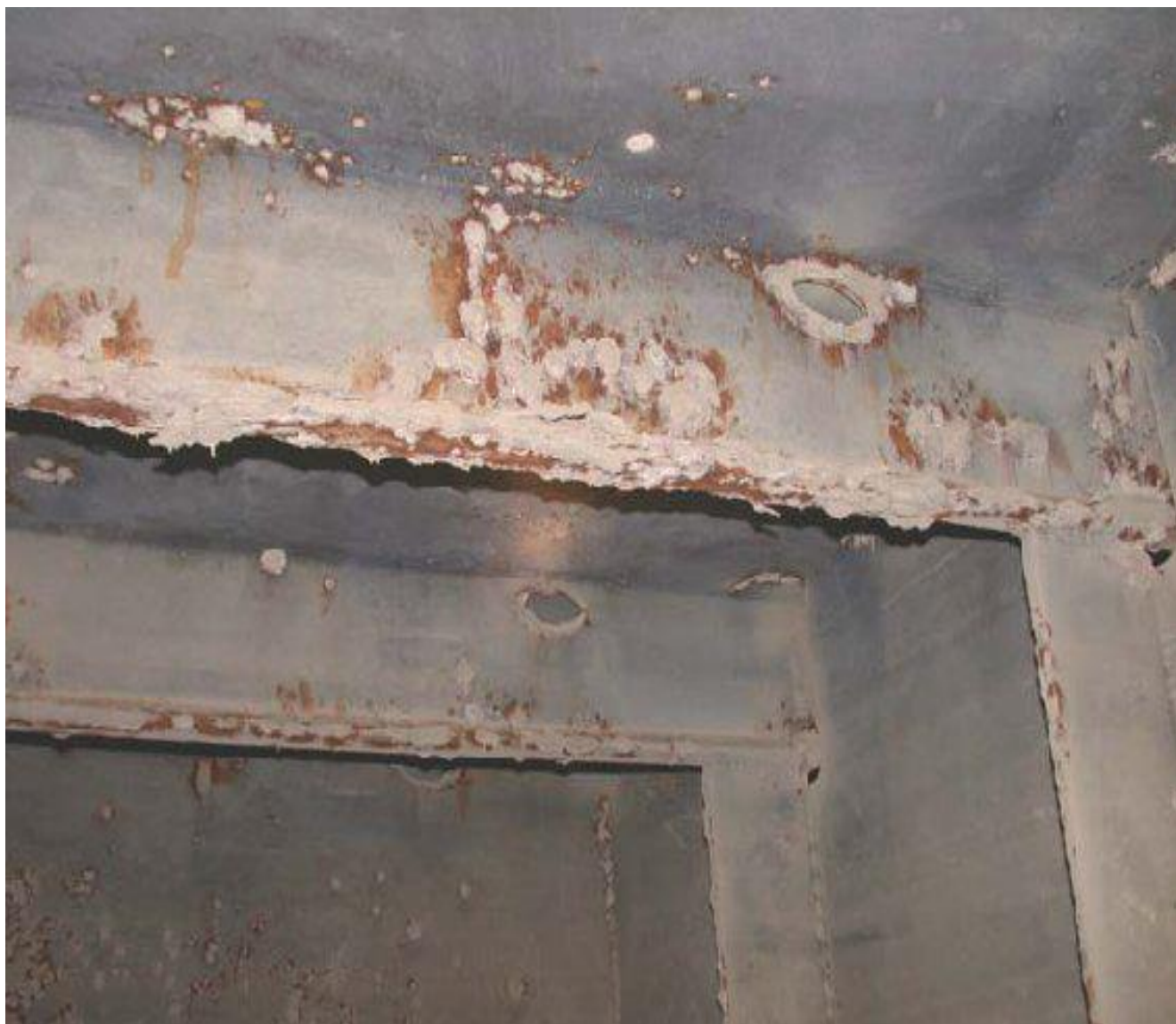
Εικόνα 10.2 Επιστρωμά γενικά άθικτο με ορατά ίχνη διάβρωσης στα άκρα
