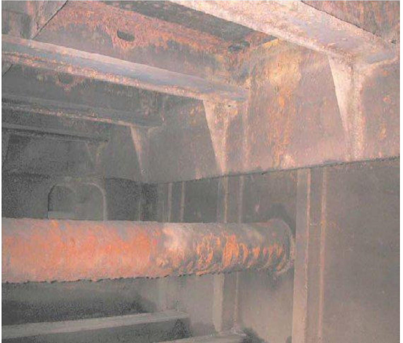
Εικόνα 10.3 Εμφανής απώλεια μετάλλου
