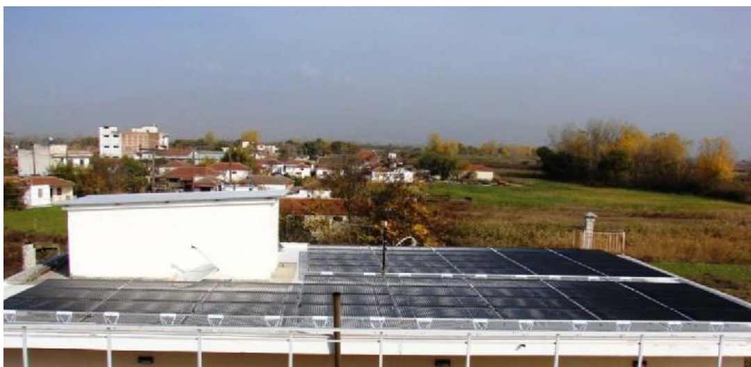
10 kW εγκατάσταση σε οικία στις Σέρρες
