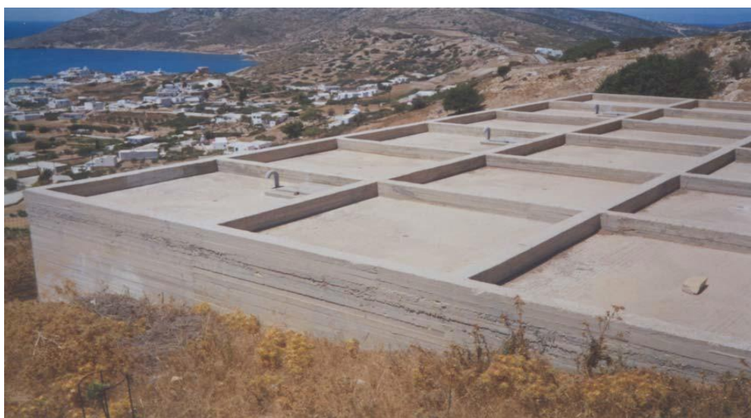
Εικόνα 31 : Η δεξαμενή των 1.000 κυβικών μέτρων εγκατεστημένη στο λόφο νοτιοδυτικά του οικισμού. [40]
