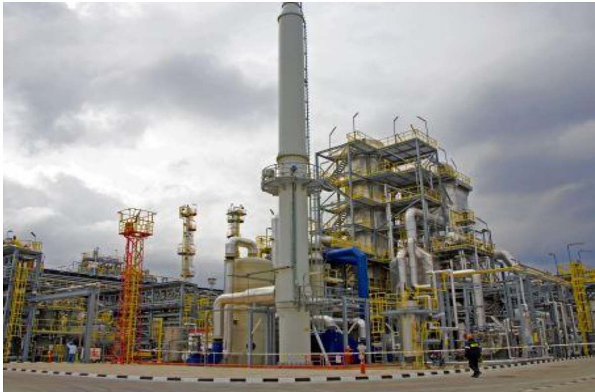
Εικόνα 2.6: Εγκαταστάσεις Διυλιστηρίου ( www.moh.gr )
