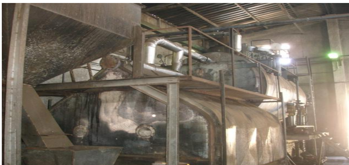
Εικόνα 21 : Ατμολέβητας με προεστία καύσης πυρηνόξυλου
