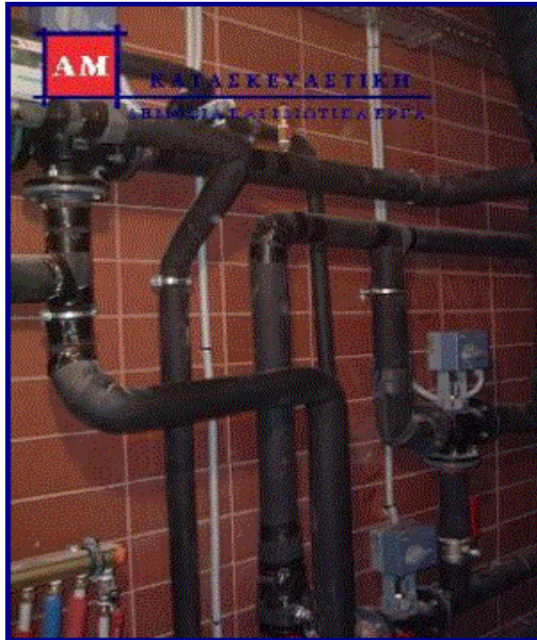
Εικόνα 7.13: Κυκλώματα νερού (Διακρίνονται οι τρίοδες βάνες για τη συνεργασία 3 των κυκλωμάτων νερού). (Κομοτηνή).
