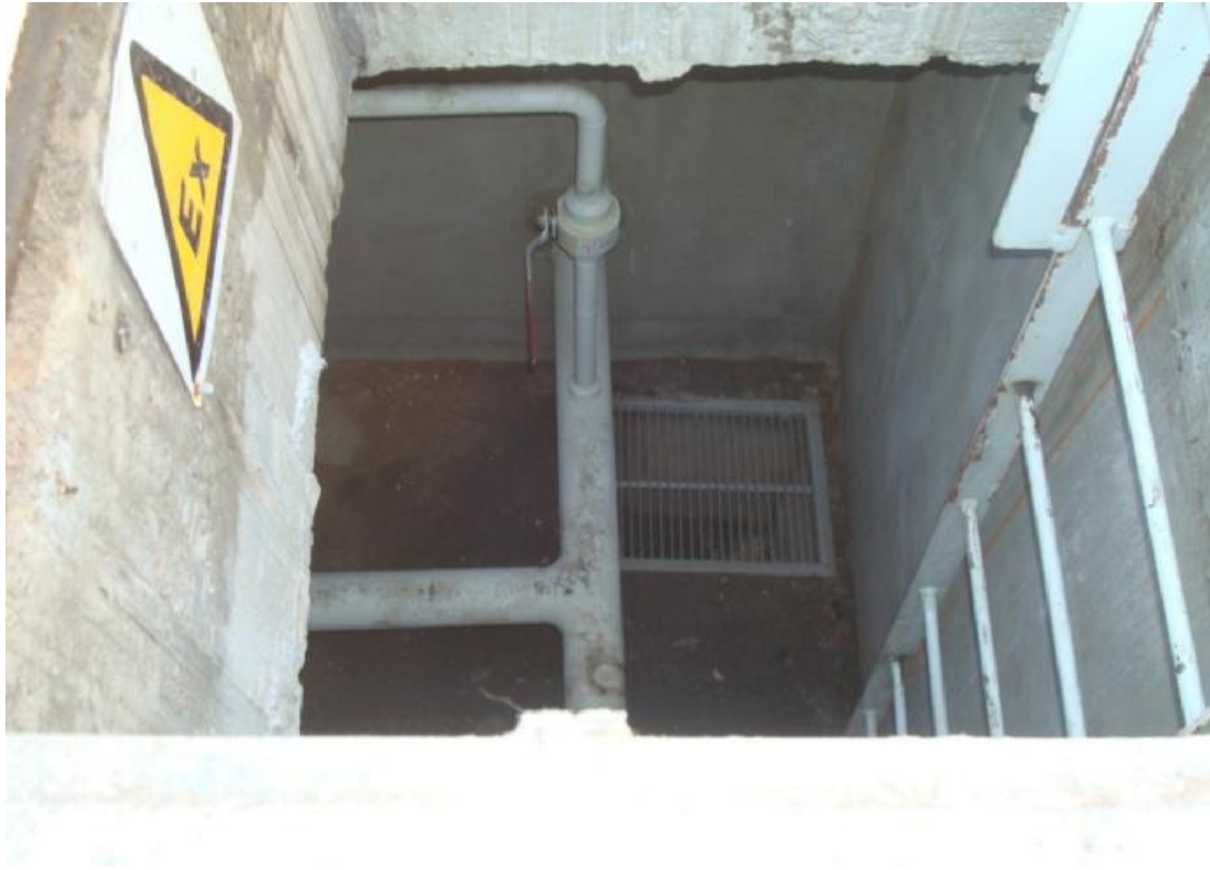
Εικόνα 9 : Βανοστάσιο με by-pass
