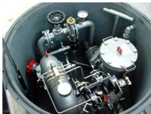
Εικόνα 11 : Υπόγειος σταθμός διανομής 19/4
