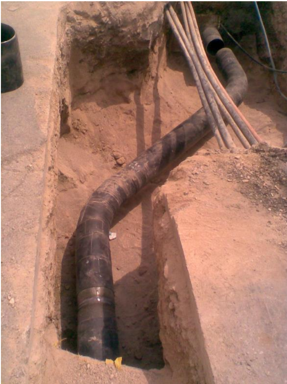
Εικόνα 5 : Χαλύβδινος αγωγός 19bar
