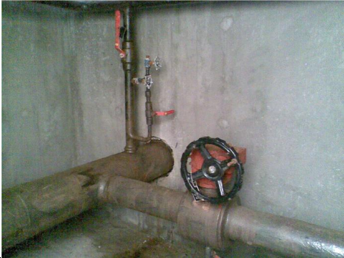
Εικόνα 7 : Βανοστάσιο με χειροκίνητη βάνα 6 ιντσών
