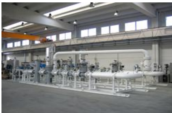
Εικόνα 4 : Σταθμός τροφοδοσίας πόλης
