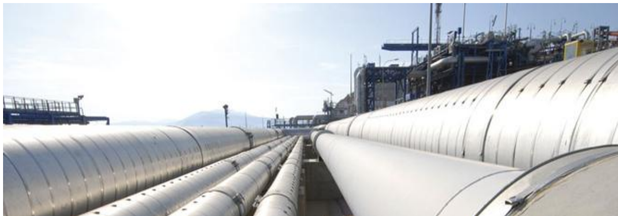
Εικόνα 2 : Κεντρικός αγωγός μεταφοράς
