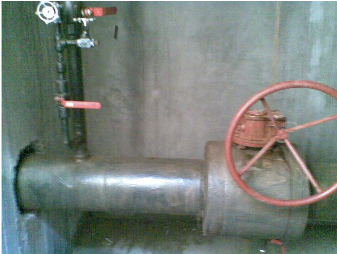
Εικόνα 6 : Βανοστάσιο με χειροκίνητη βάνα 14 ιντσών
