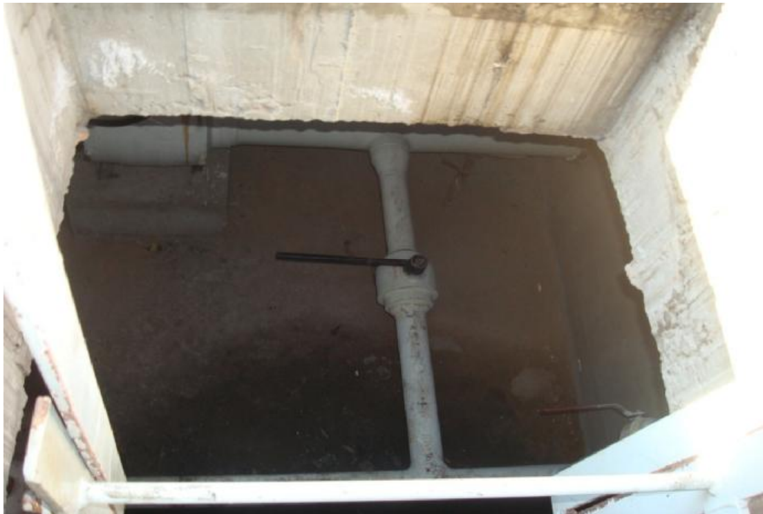
Εικόνα 8 : Βανοστάσιο με χειροκίνητη βάνα 6 ιντσών
