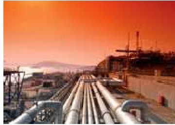
Αγωγοί Μεταφοράς Φυσικού Αερίου σε αέρια φάση
