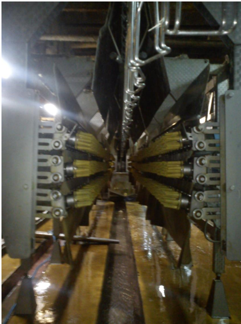
Εικόνα No.7 – Tunnel Picker Electric lincomatic
