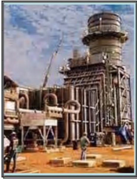
Εικόνα 4.1 Σταθμός παραγωγής Φυσικού Αερίου.
