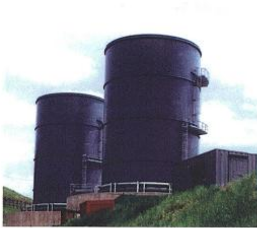
Εικόνα 8: Εσωκλειόμενη καπνοδόχος σε μια εγκατάσταση αιθυλενίου
