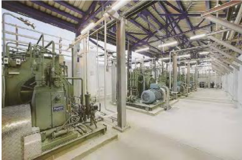
Εικόνα 4.23: Συμπιεστές φυσικού αερίου
