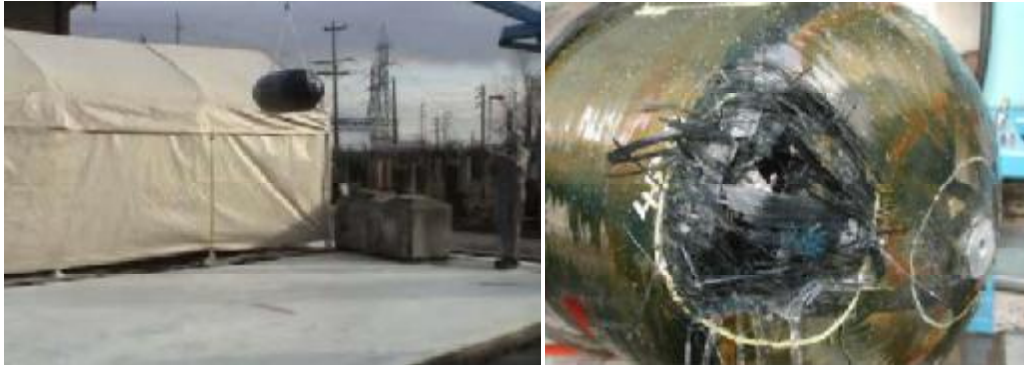
Εικόνες 4.20: Εμφάνιση των ζημιών από κρούσεις Η εκτίμηση ζημιάς είναι δύσκολη οπτικά για τον τεχνίτη ειδικά στις δεξαμενές με περικάλυμμα
