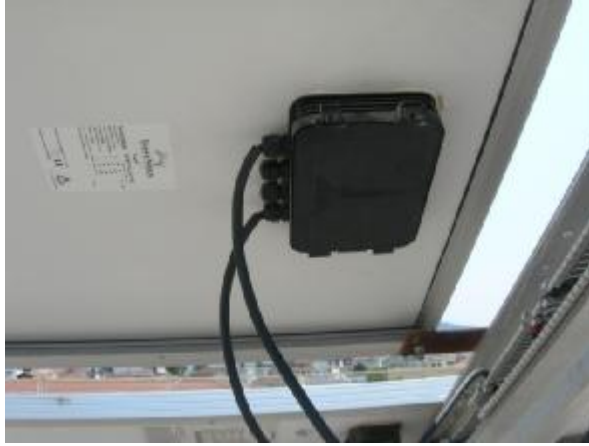
Εικόνα. 2.5: Δίοδος παράκαμψης (bypass diodes) σε εγκατεστημένο φ/β πλαίσιο.
