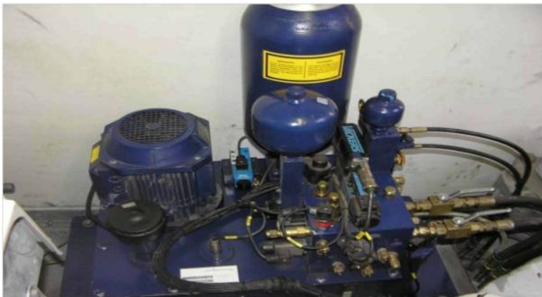
Σχήμα 7.7: Φωτογραφία της αντλίας λαδιού τοποθετημένη στην ανεμογεννήτρια
