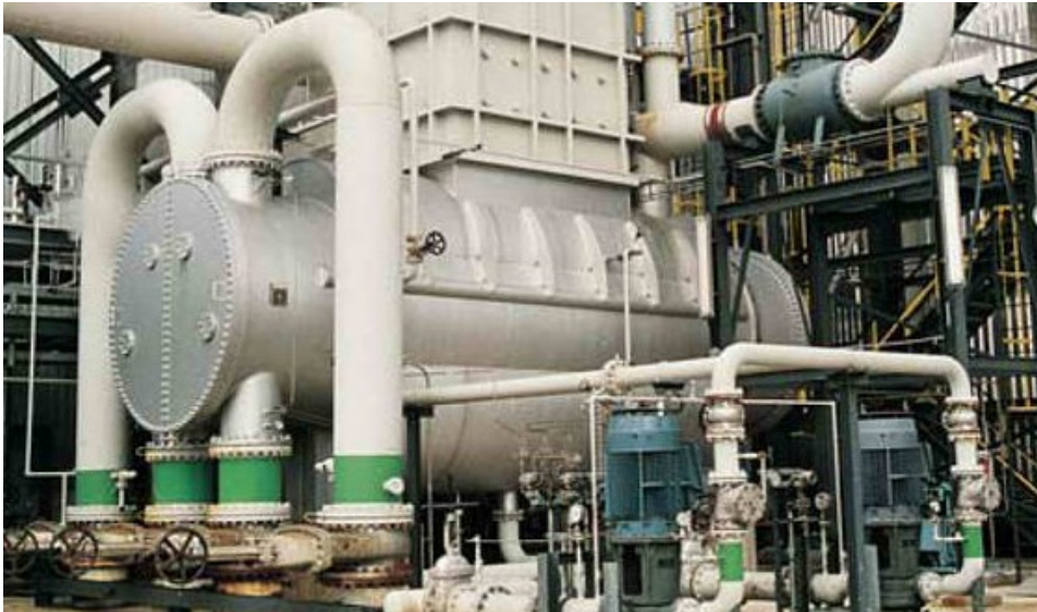
Εικόνα 36: Πλήρης εγκατάσταση ενός συμπυκνωτή.
