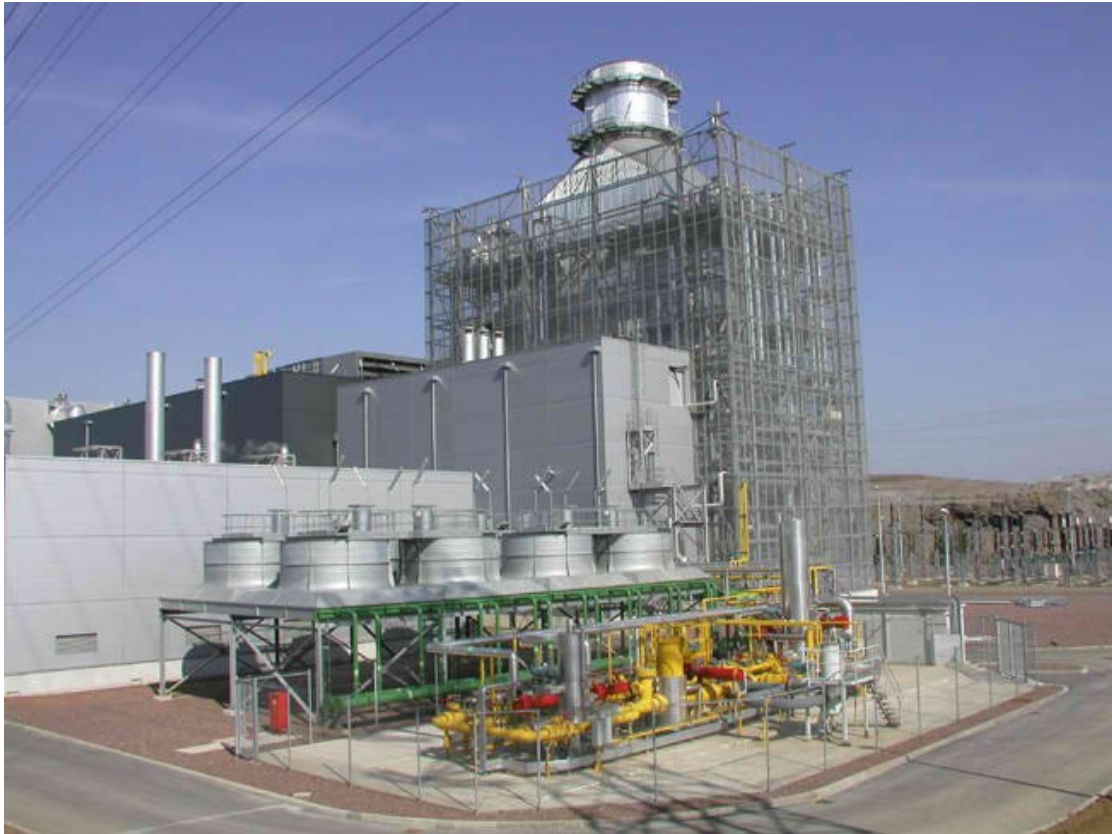
Εικόνα 46: Ένα σύστημα αεροψυγείων.
