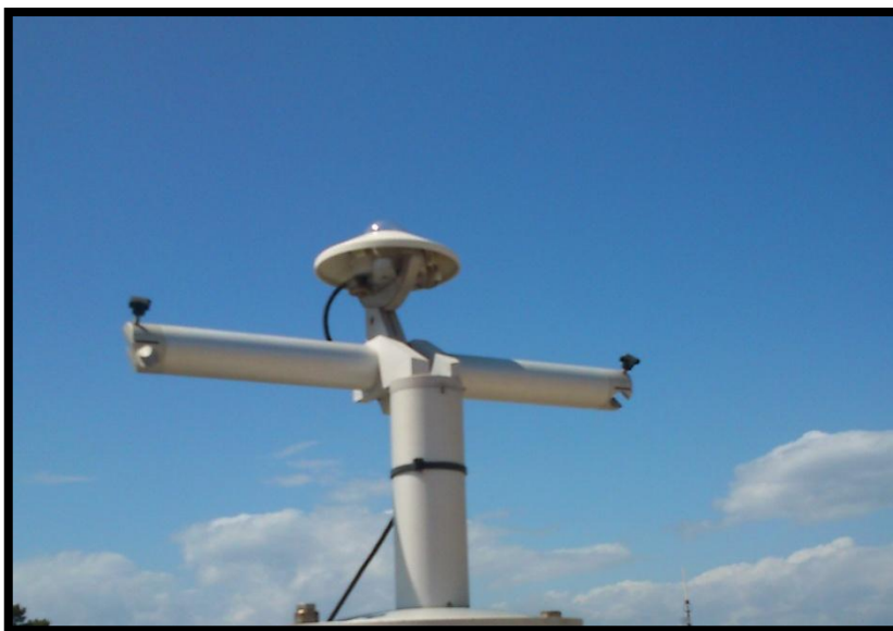
Εικόνα 3.3 : Πυρανόμετρο μετεωρολογικού σταθμού εργαστηρίου ΑΠΕ ΤΕΙ Πάτρας για την μέτρηση της έντασης της ολικής ηλιακής ακτινοβολίας
