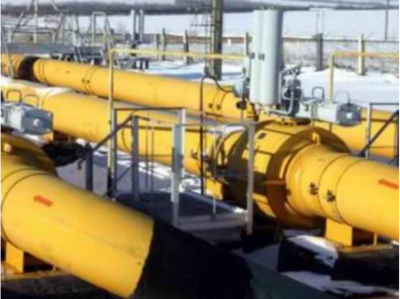
ΕΙΚΟΝΑ 2.3.2. Εγκαταστάσεις δικτύου φυσικού αερίου
