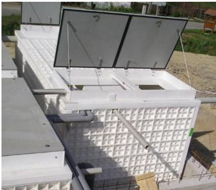
Μονάδα AS-VARIOcompN. Διακρίνονται οι ανθρωποθυρίδες επίσκεψης και ελέγχου.
