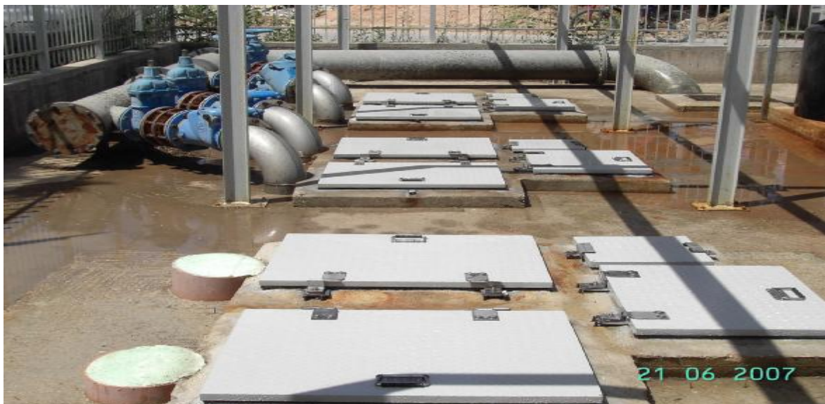
Ε1 Αντλιοστασιο Λυματων
