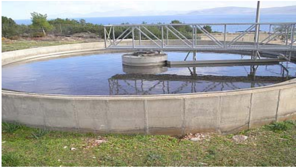
Εικόνα 3.11. Μονάδα πρωτοβάθμιας καθίζησης ( www.google.gr/images )
