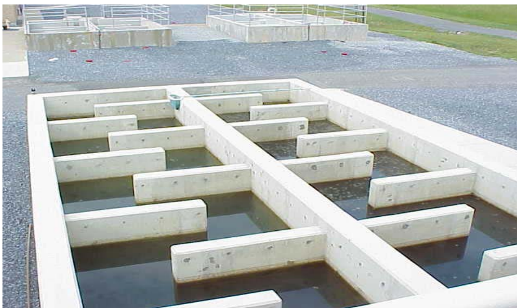
Εικόνα 5.4. Δεξαμενή χλωρίωσης, (www.google.gr/images)
