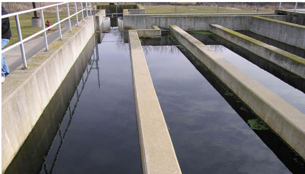
Εικόνα 5.3. Δεξαμενή χλωρίωσης, (www.google.gr/images)
