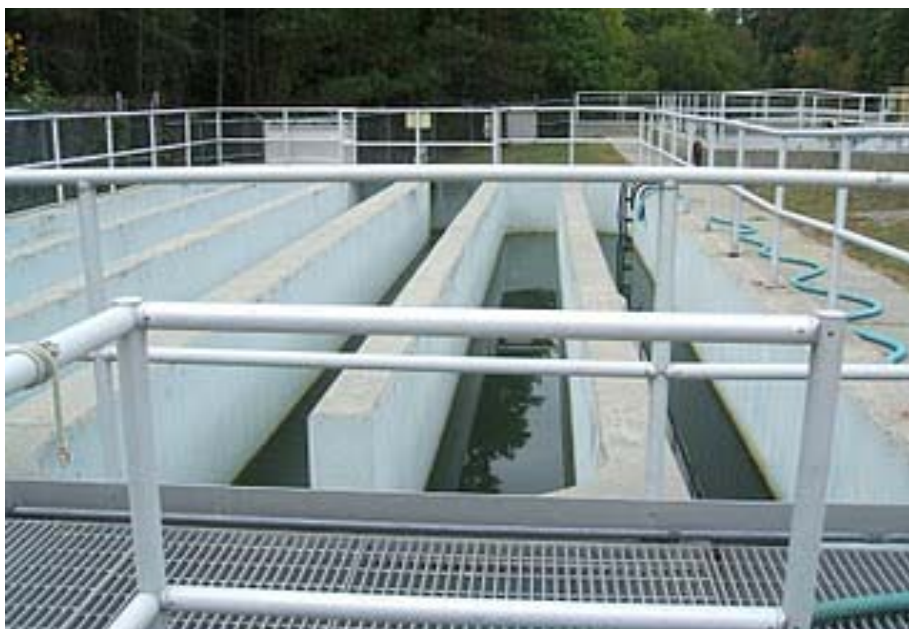
Εικόνα 3.20. Δεξαμενή χλωρίωσης. ( www.google.gr/images )
