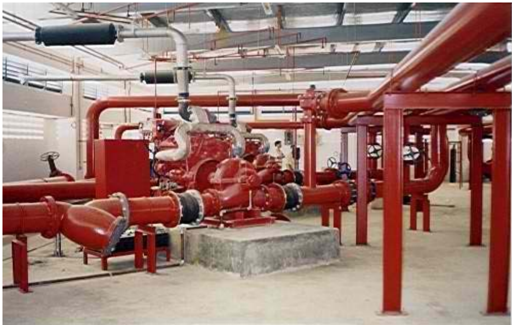
Εικόνα 6.2. Εγκατάσταση αντλιών, (www.google.gr/images)
