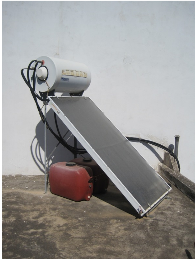
Εικόνα 3.5: Ηλιακός θερμοσίφωνα στην οροφή του 1 ου ορόφου
