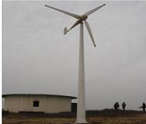
Εικόνα 6.6. Ανεμογεννήτρια παραγωγής 3 KW
