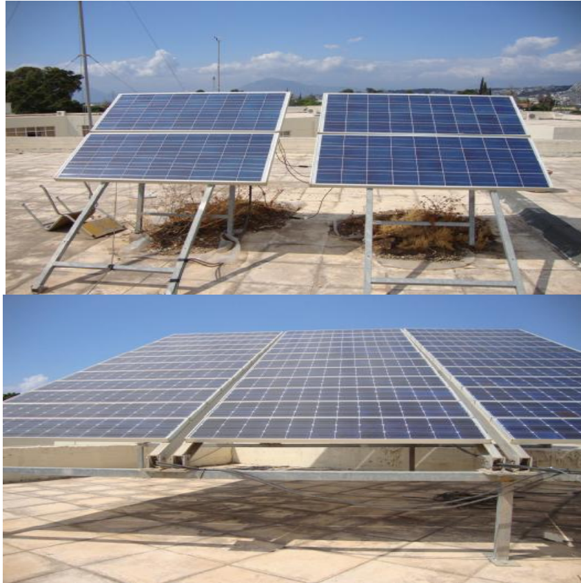
Εικόνες 2.2.2.1 & 2.2.2.2: Σταθερά Φ/Β συστήματα τοποθετημένα σε στέγη Πηγή: Εργαστήριο Η.Μ.Ε Πάτρα
