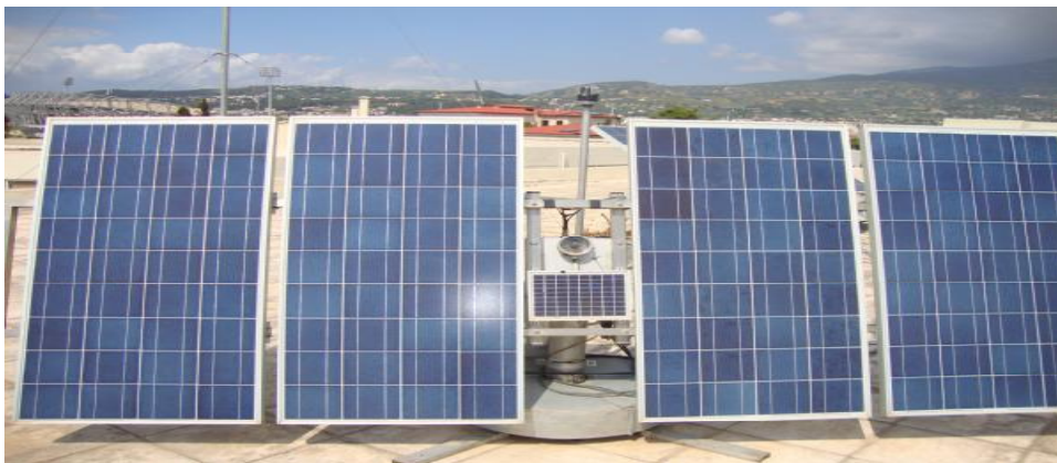
Εικόνα 2.2.2.3: Κινούμενο (tracker) Φ/Β σύστημα τοποθετημένο στη στέγη Πηγή: Εργαστήριο Η.Μ.Ε Πάτρα
