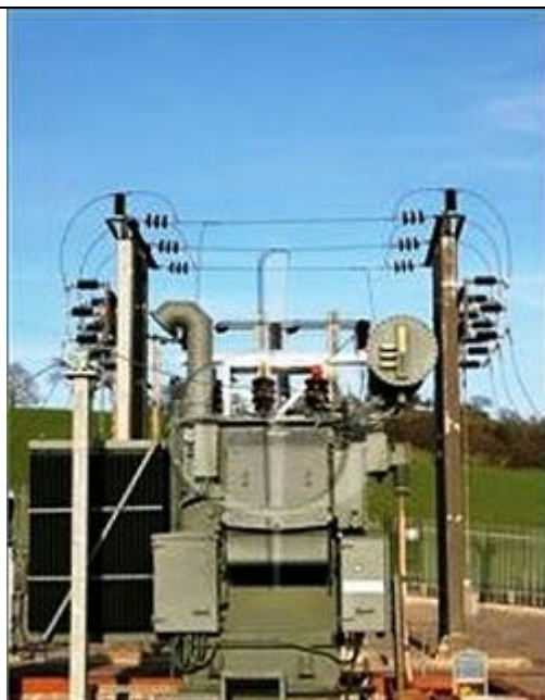
ΕΙΚΟΝΑ 2.4: Μετασχηματιστής ελαίου-υποσταθμοί
