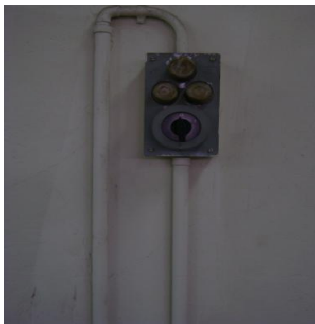
Φωτογραφία 2.3 : Τριφασικός πίνακας με ρελέ.
