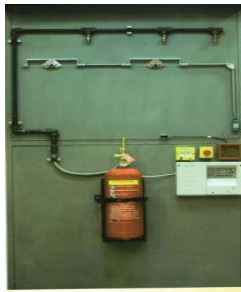
Εικόνα 3.9 : Αυτόματο σύστημα κατάσβεσης τοπικής εφαρμογής
