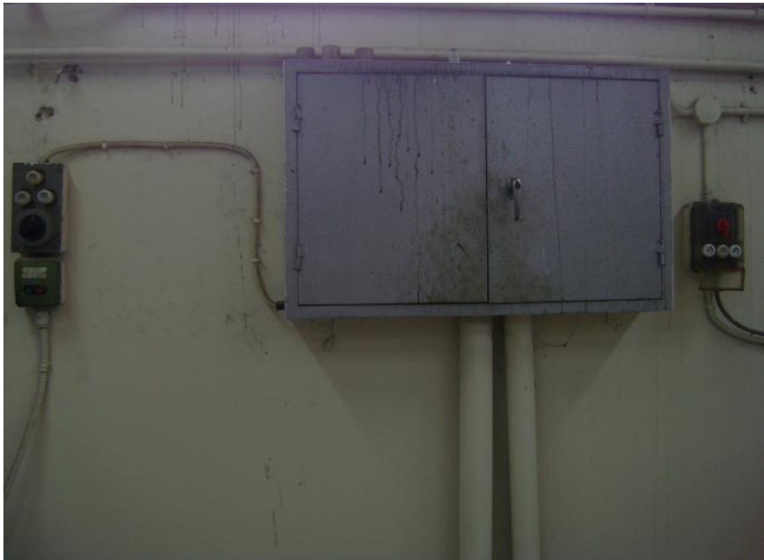
Φωτογραφία 2.4 : Ηλεκτρολογικός πίνακας
