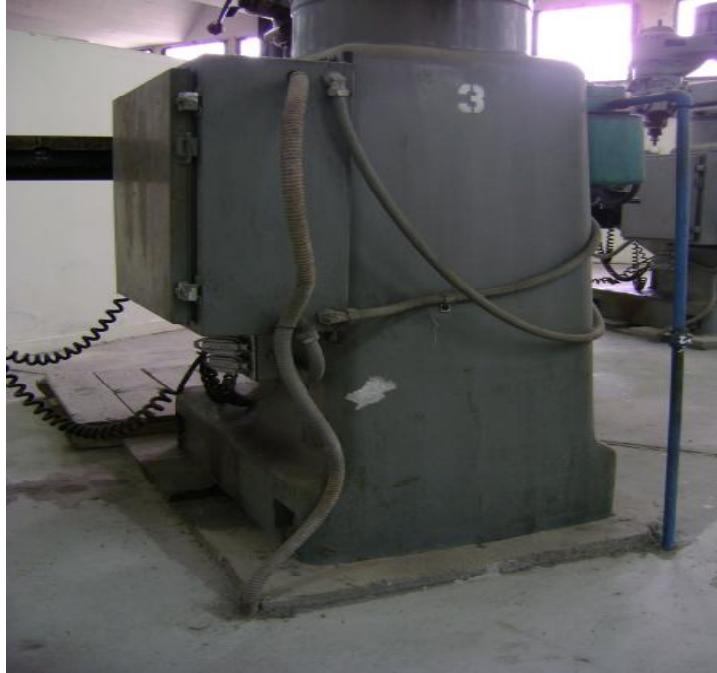
Φωτογραφία 2.2 : Ηλεκτρική εγκατάστασή.
