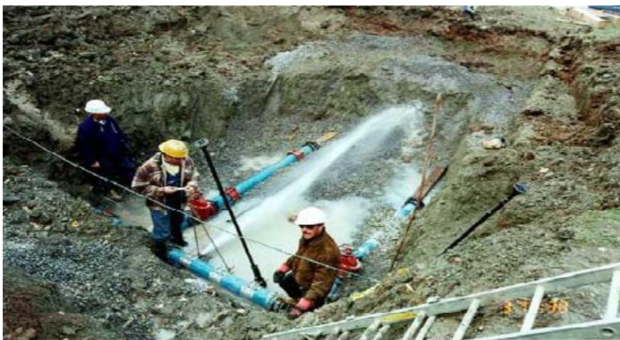
Εικόνα 3.2: Νερό που εκτοξεύεται υπό πίεση.
