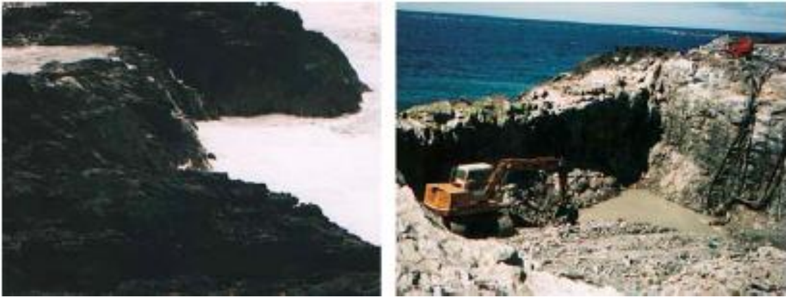
Πάνω: Λεπτομέρειες τῆς κατασκευῆς τοῦ σταθμοῦ LIMPET .
