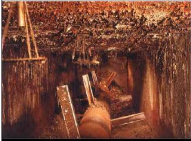
Εικόνα 5.2: Εσωτερικό δεξαμενής διύλισης.
