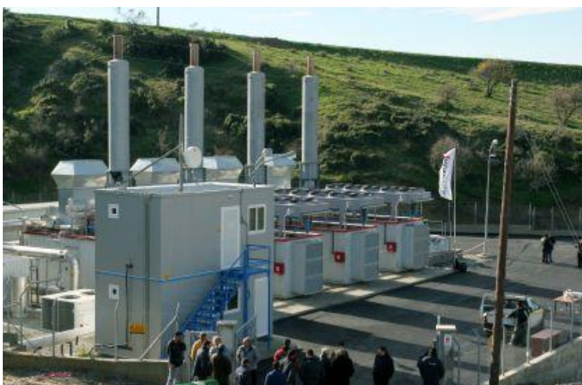
Σχήμα 19: Σταθμός ηλεκτροπαραγωγής από βιοαέριο( www.helector.gr )
