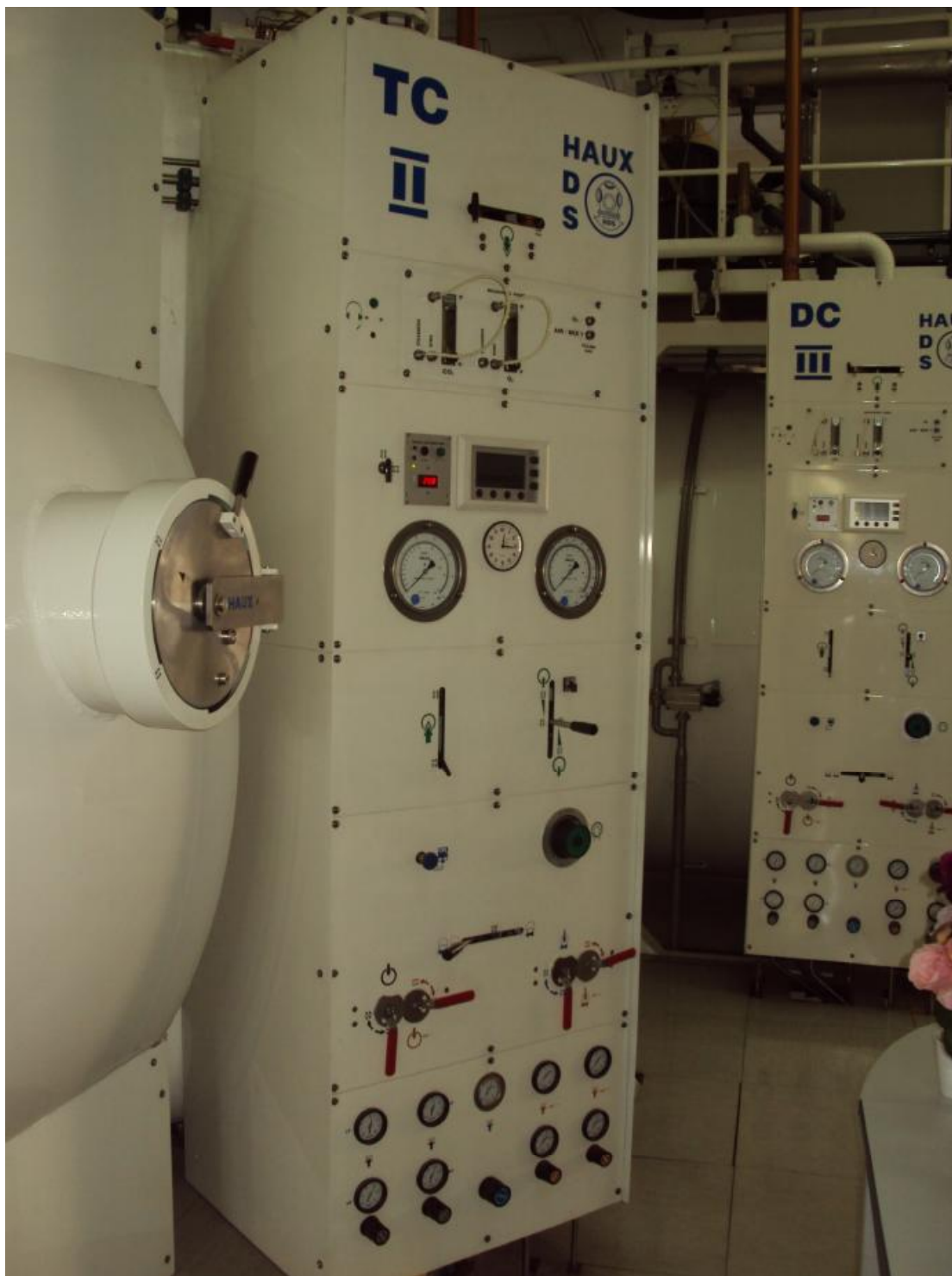
Εικόνα 37: Χειροκίνητο πάνελ εξωτερικά από τον μεγάλο θάλαμο
