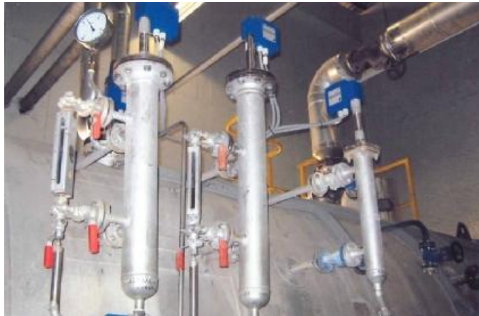
Ηλεκτρόδια ελέγχου στάθμης νερού
