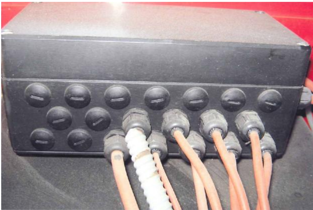
Ηλεκτρικό σύστημα θέρμανσης κυκλοφορίας μαζούτ
