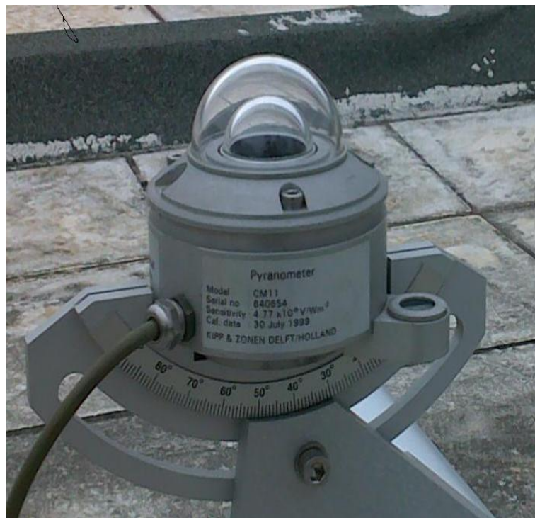
Σχήμα 2.5: Πυρανόμετρο CM11 της kipp & zonen τοποθετημένο στη στέγη του κτηρίου των Α.Π.Ε του Τ.Ε.Ι Πάτρας.
