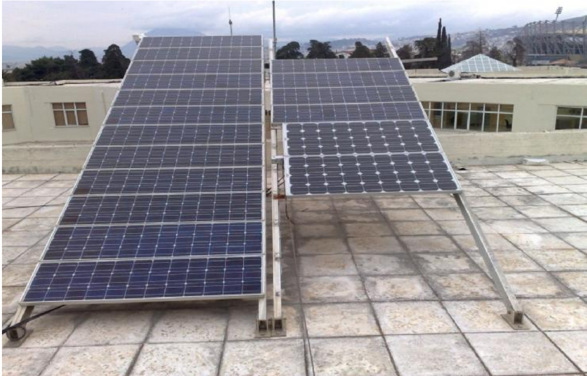
Σχήμα 3.2: Αυτόνομη φωτοβολταϊκή γεννήτρια στην οροφή του κτιρίου των Α.Π.Ε η οποία τροφοδοτεί το συμβατικό ψυκτικό θάλαμο του εργαστηρίου μας.
