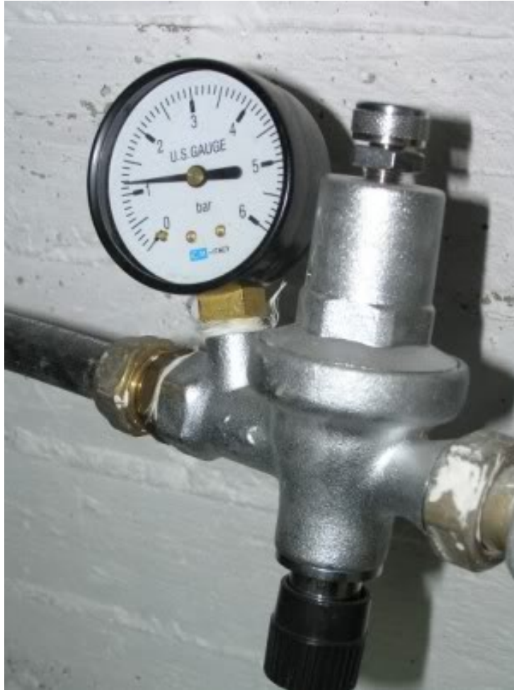
ΕΙΚΟΝΑ 2.24: Αυτόματος πλήρωσης
