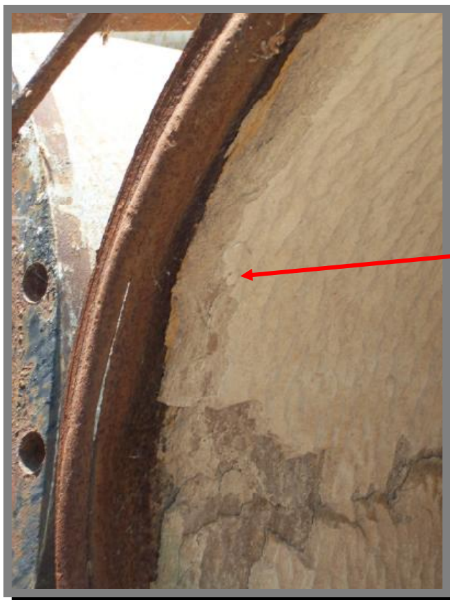
Εικόνα 61: Εσωτερική επιφάνεια αντικατεστημένου αγωγού
