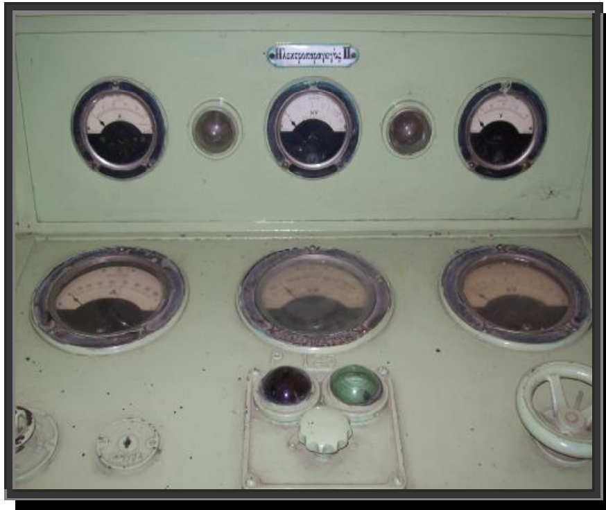
Εικόνα 30: Παλιός Πίνακας Ελέγχου
