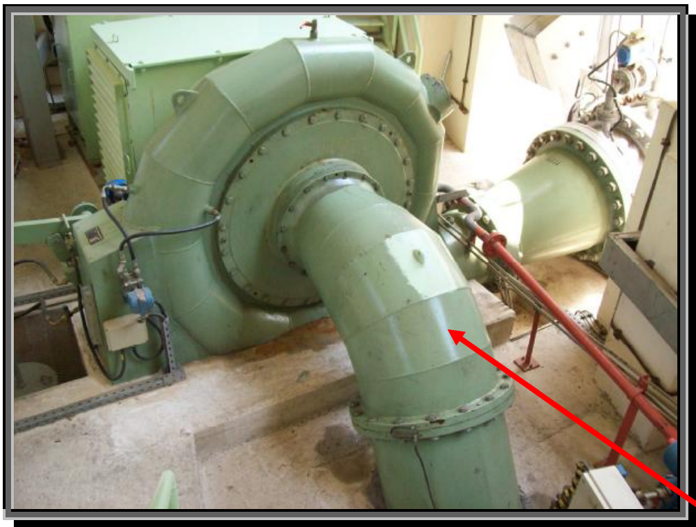
Εικόνα 75: Αγωγός Φυγής Μονάδας Francis
