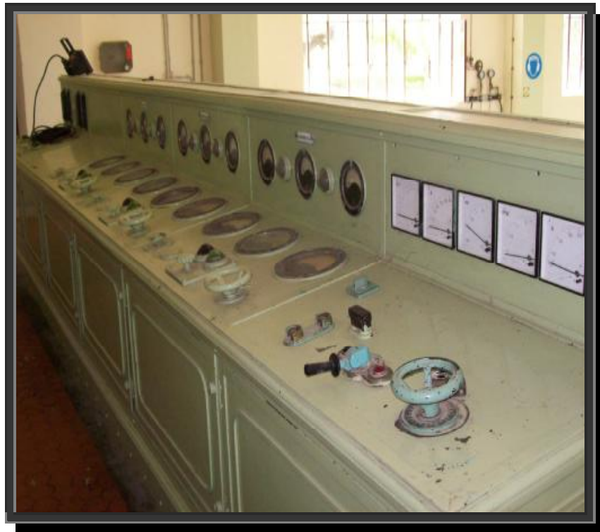
Εικόνα 31: Παλιός Πίνακας Ελέγχου
