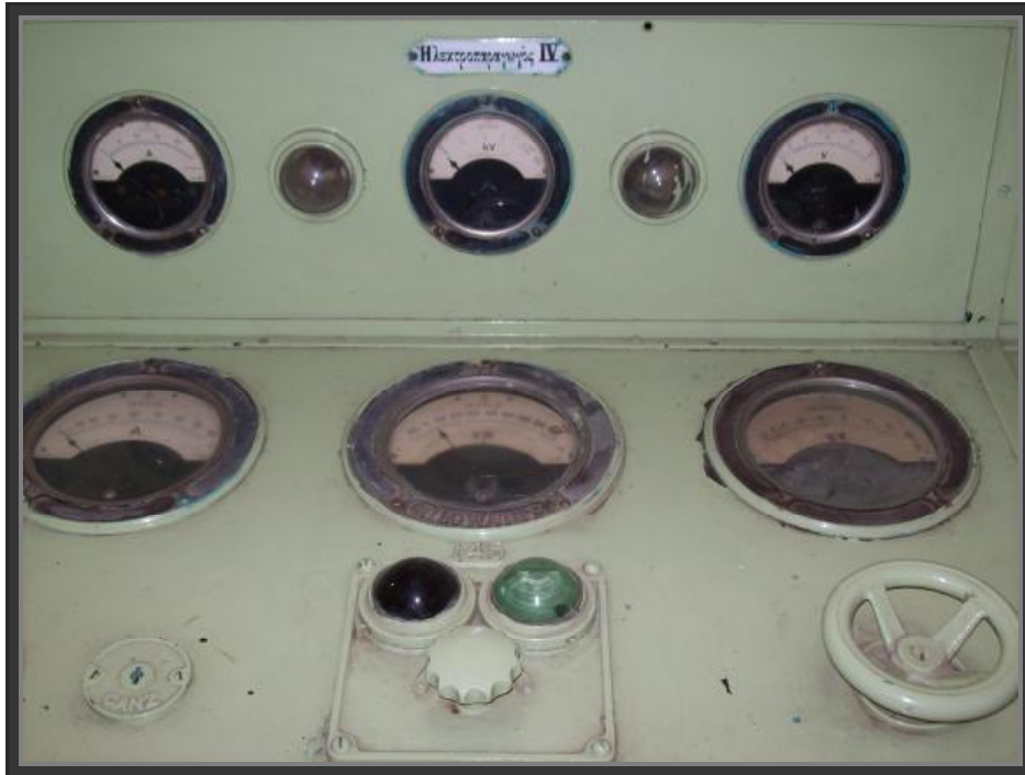
Εικόνα 28: Παλιός Πίνακας Ελέγχου
