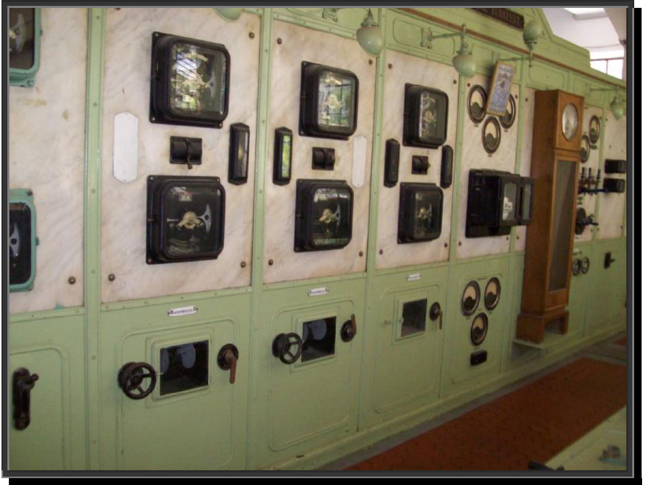
Εικόνα 32: Παλιός Πίνακας Ελέγχου
