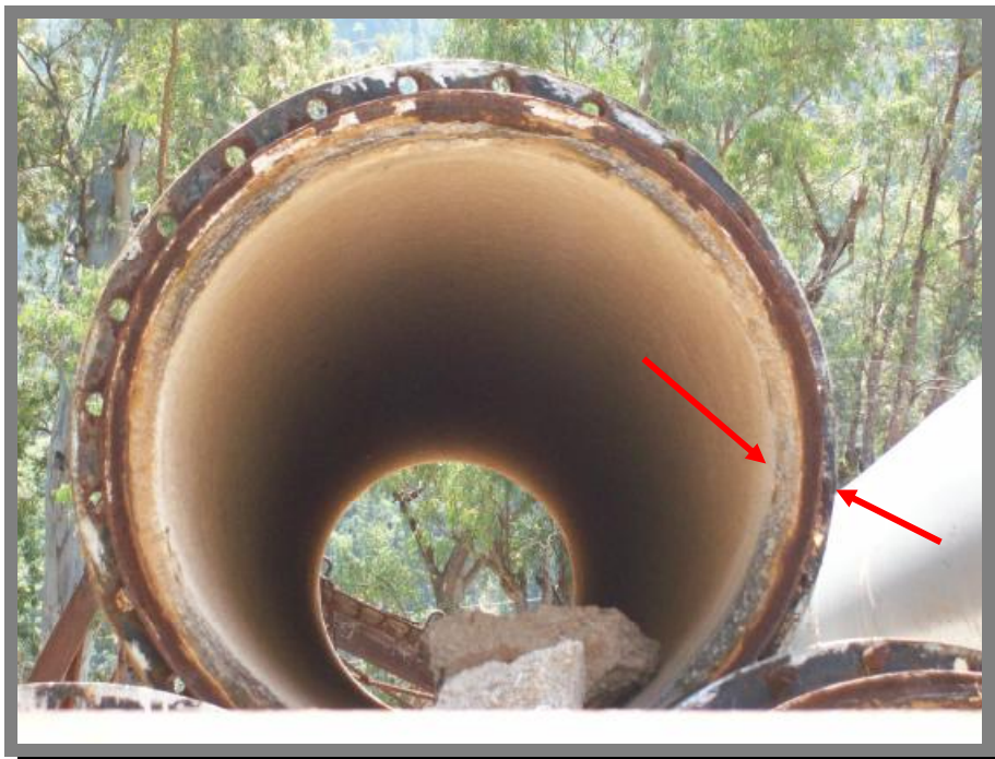
Εικόνα 60: Εσωτερική επιφάνεια αντικατεστημένου αγωγού
