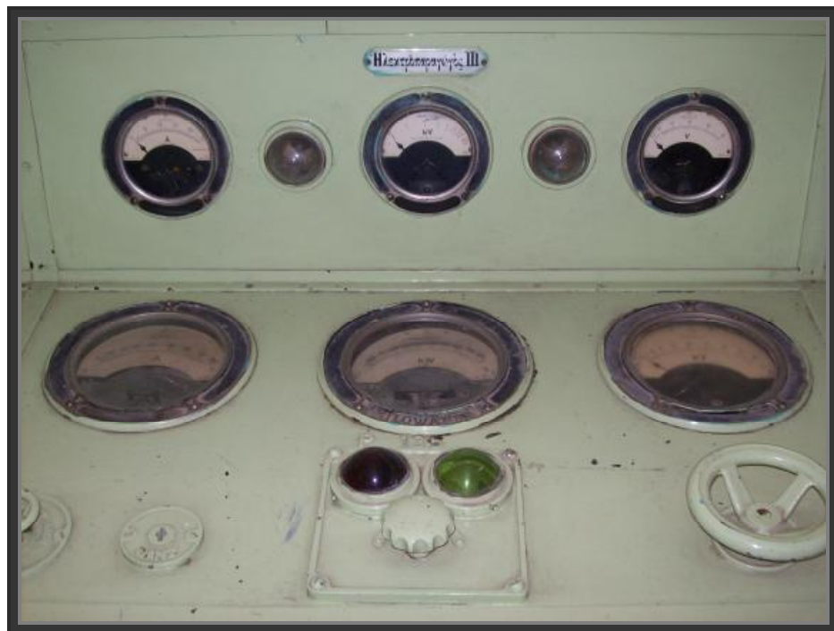
Εικόνα 29: Παλιός Πίνακας Ελέγχου
