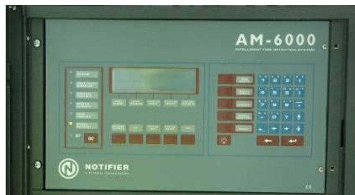
Εικόνα 7.1: Κεντρικός πίνακας πυρανίχνευσης
