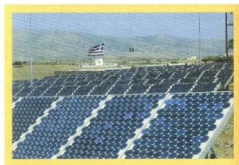
Σχήμα 5.10. Το φωτοβολταϊκό πάρκο της ΔΕΗ στην Κύθνο
