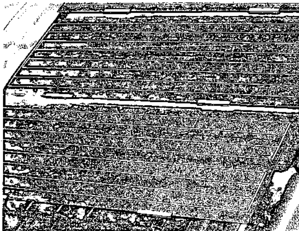
Σχήμα 3-4. Φωτοβολταϊκά πλαίσια σε στέγη με κεραμίδια
