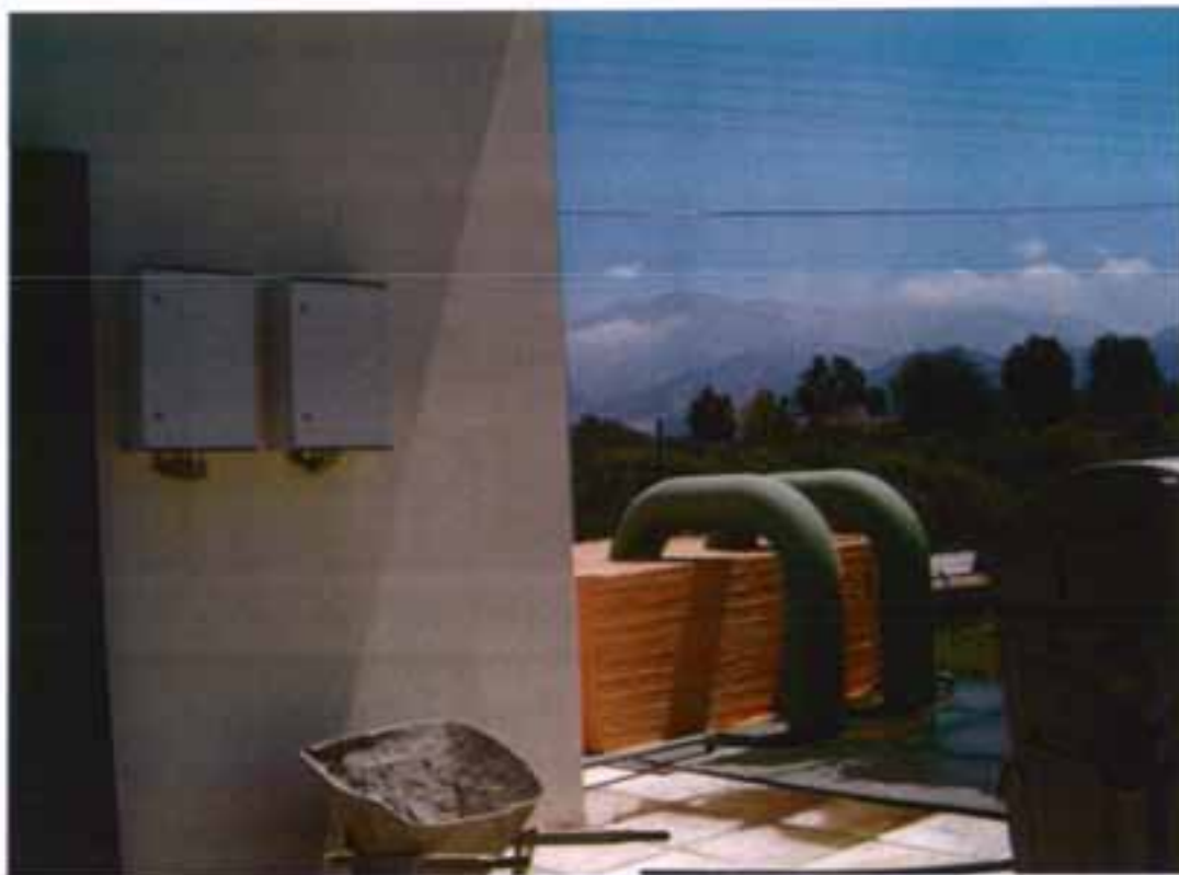
Κτίριο χονδροεσχάρωσης – Φρεάτιο ΚΑΑ – Δίδυμος καταθλιπτικός Αγωγός Δ. Παραλίας
