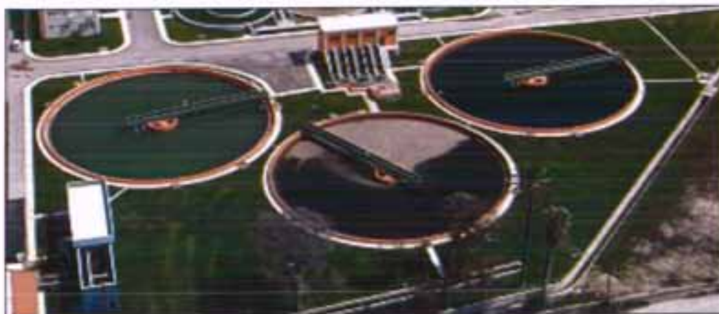
Δεξαμενές Δευτεροβάθμιας Καθίζησης
