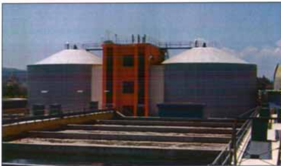
Χωνευτές ιλύος – κτίριο αντλιών εναλλακτών λεβήτων
