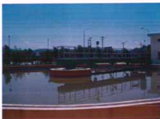
Δεξαμενή πρωτοβάθμιας καθίζησης – Γέφυρα
