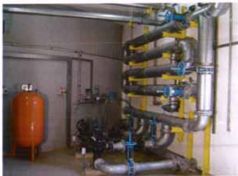
Εναλλάκτης Θέρμανσης Ιλύος
