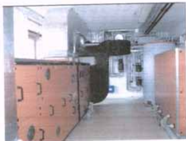
Σχήμα 6,6 Σύστημα ψύξης υγρού μέσου DEC εγκατεστημένο στο νέο κτίριο του "Solar Building Innovation Center (SOBIC)" στο Freiburg (D)
