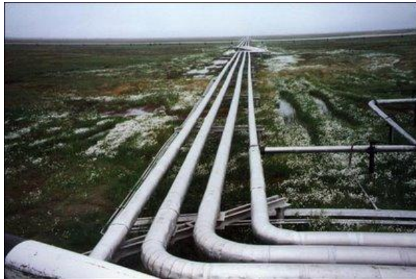
Αγωγοί φυσικού αερίου στη βόρεια Σιβηρία. Ο ενεργειακός πλούτος του υπεδάφους της απέραντης αυτής περιοχής είναι ανεξάντλητος
