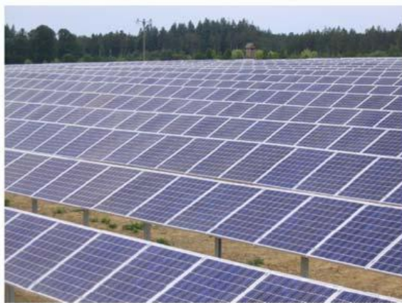
Εικ.2.16 Διασυνδεδεμένο φωτοβολταϊκό πάρκο ισχύος 2MW στη Γερμανία.
