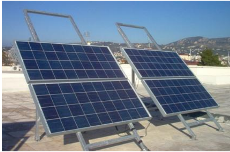
Εικ.3.4 Φωτοβολταϊκά πλαίσια τοποθετημένα με σταθερή γωνία κλίσης (Εργαστήριο Ήπιων Μορφών Ενέργειας ΤΕΙ ΠΑΤΡΑΣ)
