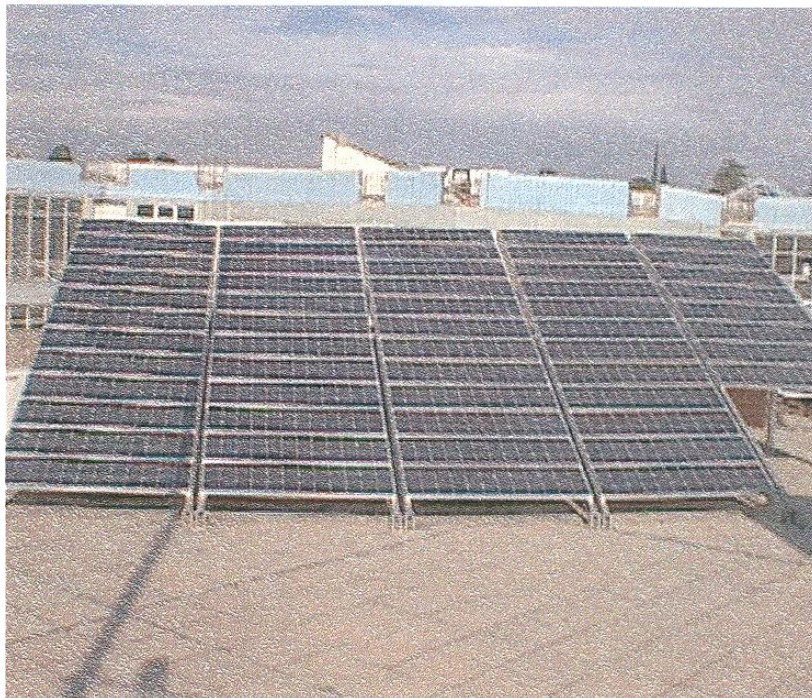
Εικ.2.15: Συστοιχία φωτοβολταϊκών πλαισίων του εργαστηρίου Ήπιων Μορφών Ενέργειας ΤΕΙ ΠΑΤΡΑΣ που λειτουργεί αυτόνομα σε περίπτωση διακοπής του ρεύματος.
