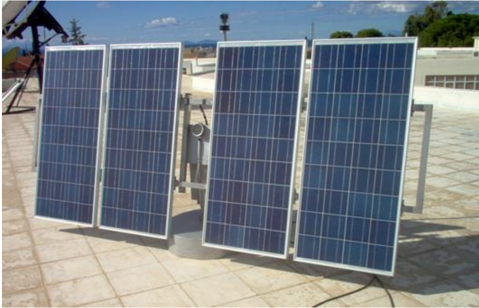
Εικ.3.7 Φωτοβολταϊκά πλαίσια τοποθετημένα που περιστρέφονται γύρω από έναν άξονα. (Εργαστήριο Ήπιων Μορφών Ενέργειας ΤΕΙ ΠΑΤΡΑΣ)
