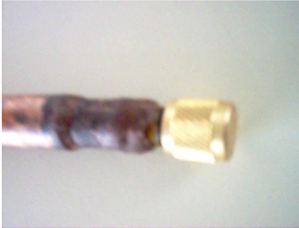
Σχήμα 5. Βαλβίδα πλήρωσης τοποθετημένη πάνω στο σωλήνα.
