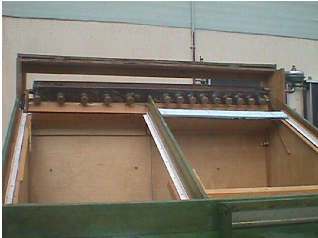
Άποψη του οικίσκου κατά τη διάρκεια της κατασκευής, πριν την ενσωμάτωση της ενεργειακής οροφής. Στη κορυφή διακρίνεται ο εναλλάκτης θερμότητας.
