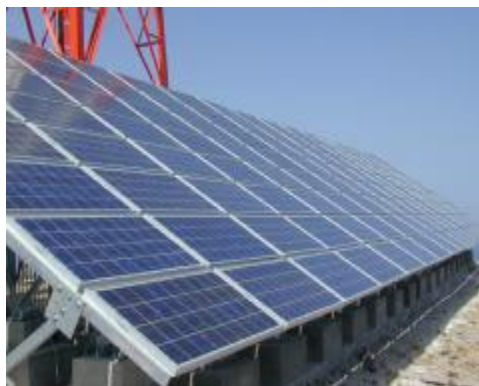
Εικόνα : Συστοιχία φωτοβολταϊκών ( πηγή: Σύνδεσμος Εταιρειών Φωτοβολταϊκών ΣΕΦ)
