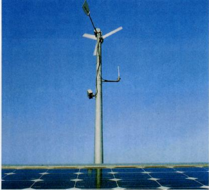
Σχήμα IV: Συνδυασμός ανεμογεννήτριας και PV πλαισίων για κάλυψη των ηλεκτρικών φορτίων. Είναι ένα αυτόνομο υβριδικό σύστημα που το συναντάμε σε περιοχές ορεινές ή μακριά από το δίκτυο σε πλήθος από εφαρμογές, βλ. σχήμα 6.20.
